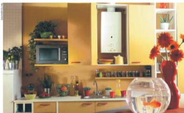
Jeśli w kuchni na kuchenkę gazową znajduje się pochłaniacz, można zamontować dowolny rodzaj piecyka. Natomiast, gdy mamy okap podłączony do wentylacji, jedynym rozwiązaniem jest zakup piecyka z zamkniętą komorą spalania
